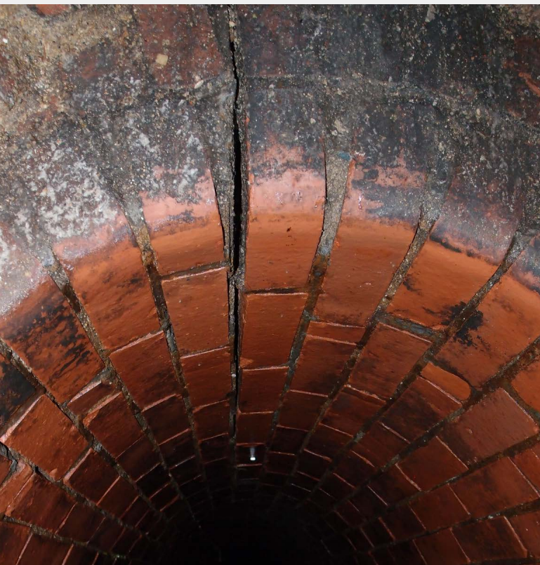
▼ Obr. 1 Trhliny v klenbě
