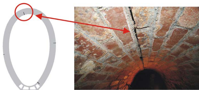
▲ Obr. 8 Porušení stoky
