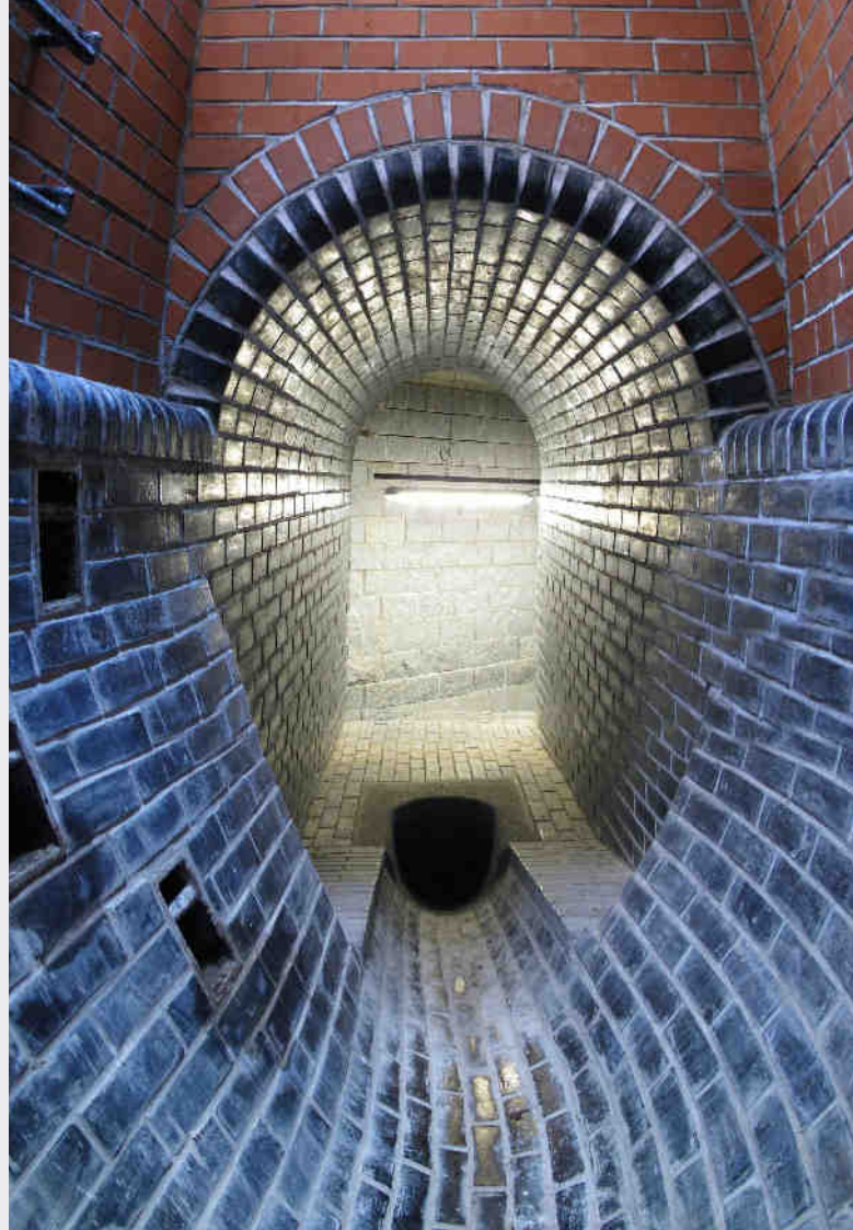
▲ Obr. 3. Nátok do komory spadištěm
