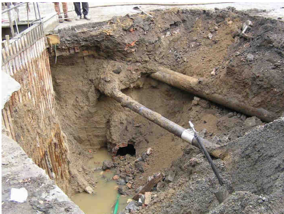
Obr. 3 – Havárie kanalizace Kováků
