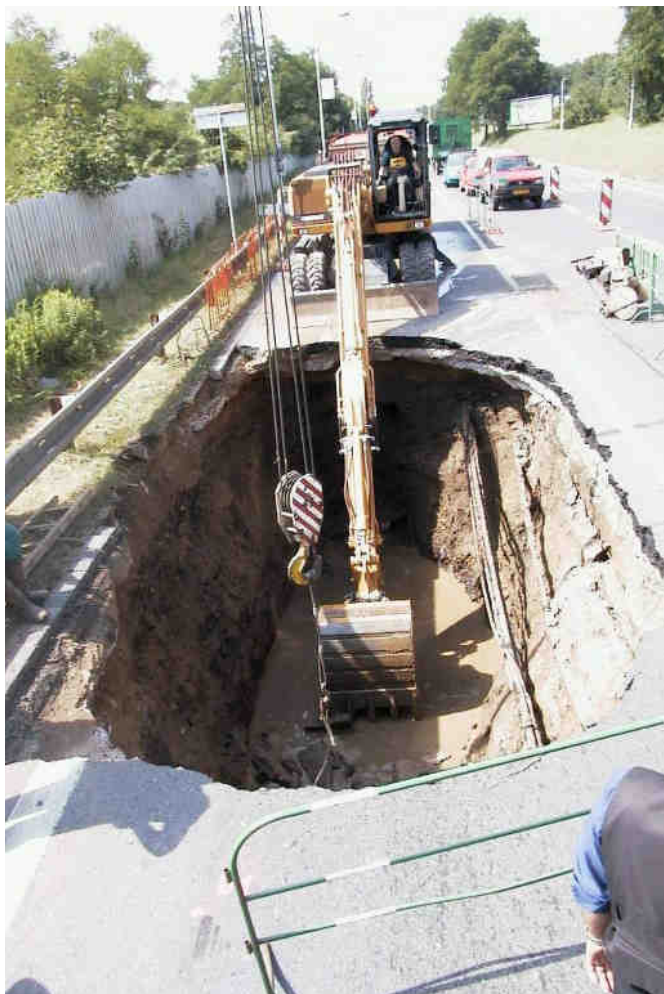
Obr. 2 – Havárie kanalizace Českobrodská
