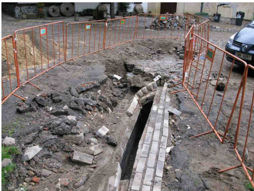
Obr. 4 – Havárie kanalizace Nový Svět
