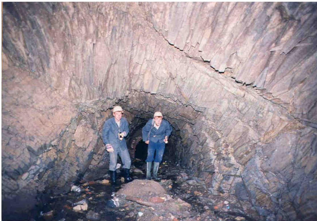
Obr. 1 – Havárie kanalizace Trojská
